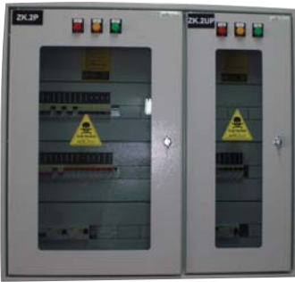
➤ Daire İçi Dağıtım Tabloları Inter-flat Distribution Tables
